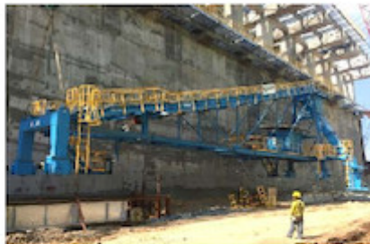
Foto 2: Der Abwurftrager wurde komplett vormontiert und mit Hilfe von Kränen auf die Schienen gehoben. (Foto SCHADE)
